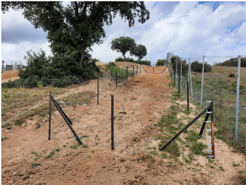
Figura 4. Vallado de exclusión de ganado en la Vereda de las Tapias de Viñuelas y del Pardo, en Colmenar Viejo (tramo erosionado LI101).
