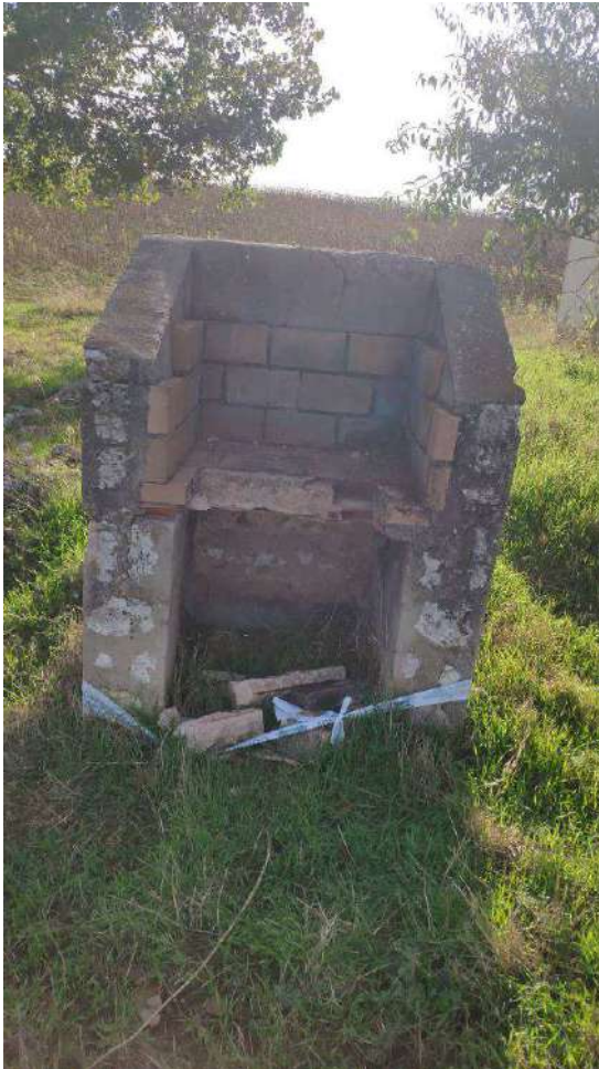
Foto 13. Barbacoa a demoler.
