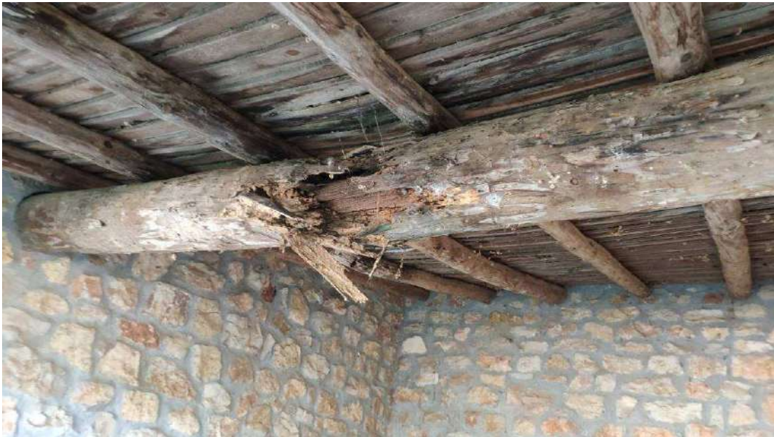
Foto4. Viga de carga a sustituir.
