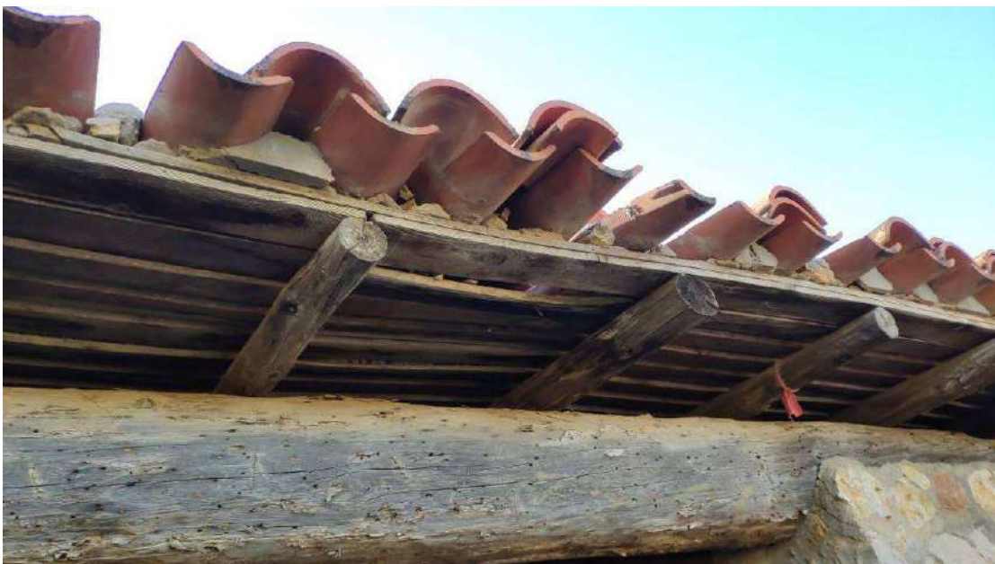
Foto5. Voladizos a reparar.
