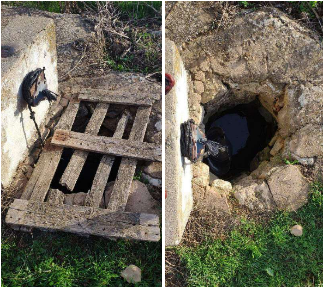
Fotos 11 y 12. Tapa a colocar en aljibe de abastecimiento manual en pequeño abrevadero.
