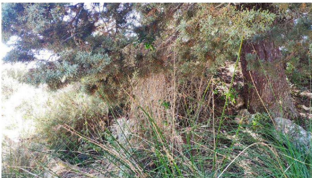
Foto 19. Estado de la captación de antigua balsa o fuente de mampostería.
